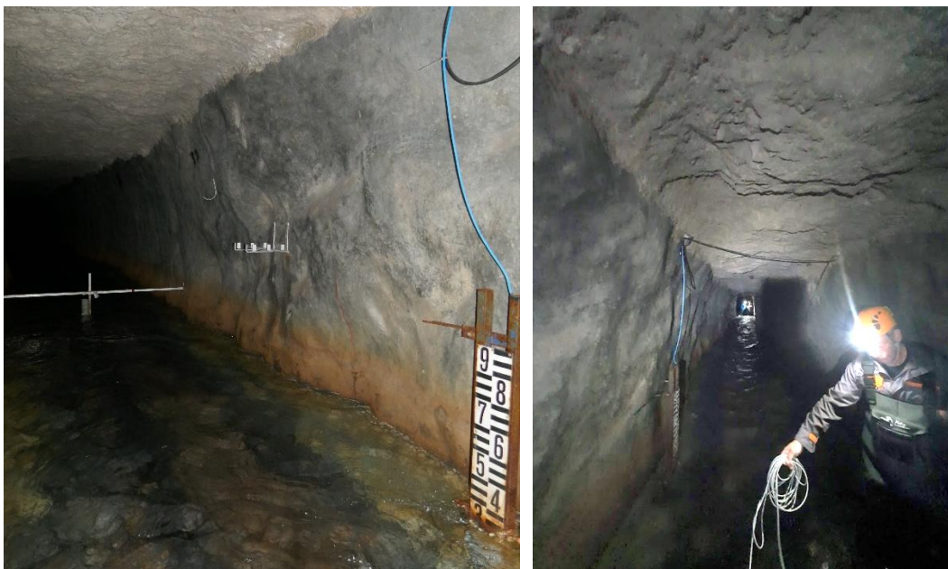
Slika 10: (levo) Merilno mesto – v vodnem rovu ob merilni lati. Podzemlje Pece uporablja koto 417 m za dno kanala na merilnem mestu. (desno) Mesto vnosa soli za umeritveno krivuljo meritve pretoka je 25 m v gorvodni smeri.
