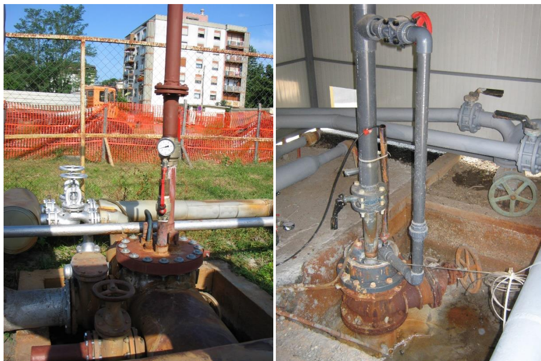
Slika 15: Izgled ustja vrtine Sob-1 (levo) in Sob-2 (desno) okoli leta 2013, ko sta še bili v uporabi
