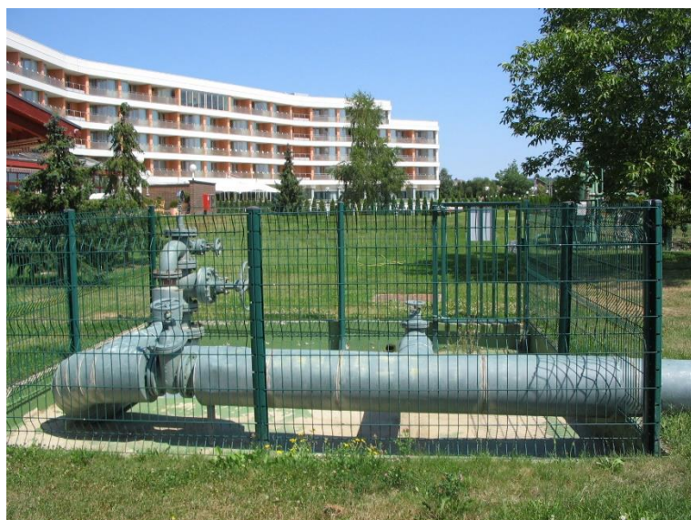
Slika 6: Primer ustja geotermalne vrtine, ki služi za ogrevanje hotelskega in bazenskega kompleksa. Foto: N. Rman
