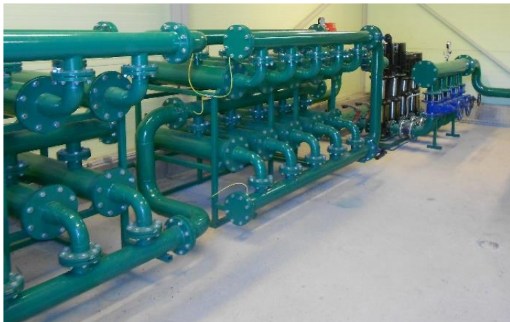
Slika 10: Primer črpalk v sistemu filtriranja pri reinjekcijski geotermalni vrtini. Foto: N. Rman
